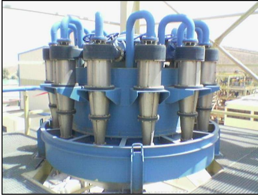
Figure 1-7 : Batterie d'hydrocyclones séparateurs
