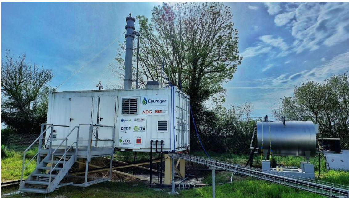
FIGURE III.1 – Photographie de l'Epurogaz sur le site de la ferme de Lamothe.
