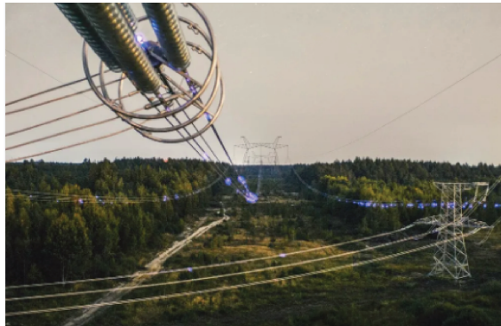
FIGURE 5.19 – Phénomène de couronne observé tout au long des câbles de transport d'électricité [Source 7 ].
