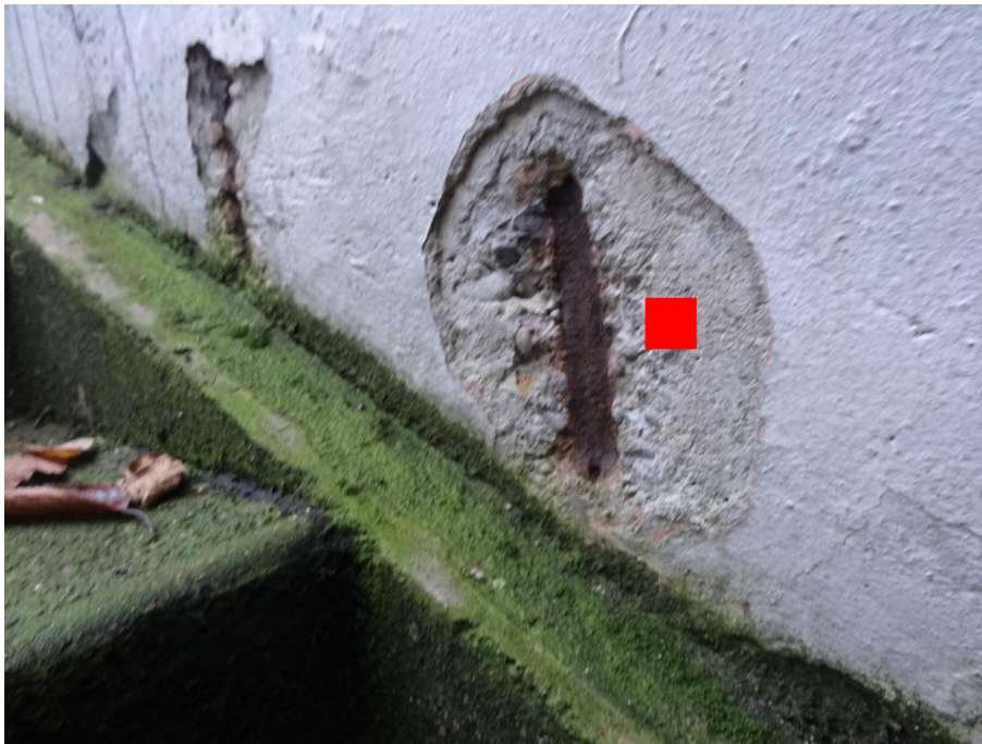
FIGURE 2.9 – Exemple de sous-image problématique (matérialisée en rouge). Elle a une résolution de 256 \times 256 pixels et est intégralement annotée comme fer apparent mais l'armature métallique n'y figure pas.
