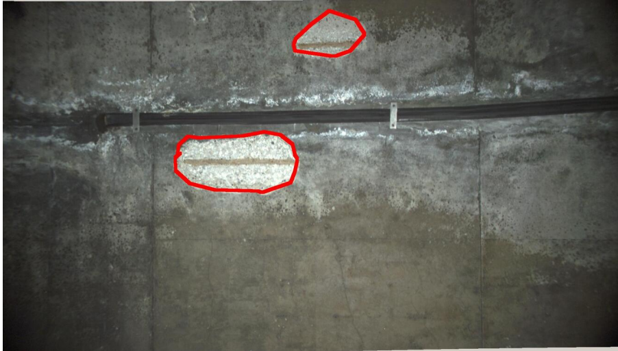
FIGURE 6.15 – Image, issue du tunnel de Rive-de-Gier, utilisée avec annotation pour l’adaptation des modèles sur ce tunnel. Les fers apparents sont détournés en rouge.
