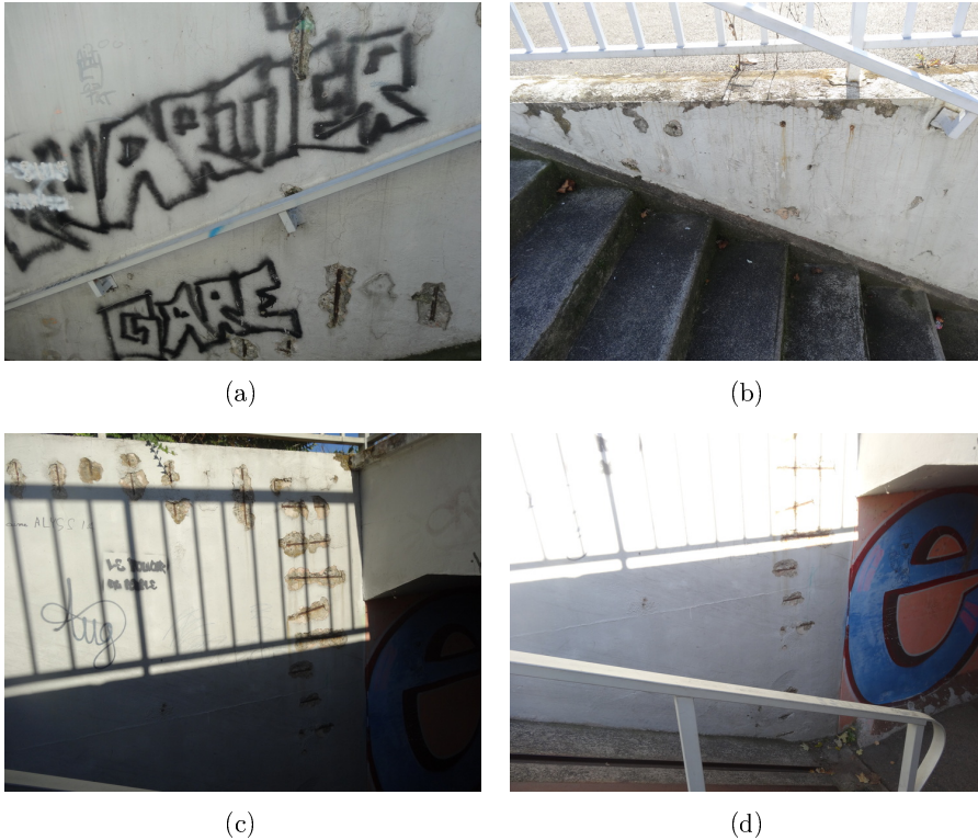
FIGURE 2.5 – Exemples issus du tunnel piéton. Dans l'image (a), des tags recouvrent la paroi tandis qu'un facteur de flare est visible sous forme de tache verdâtre dans le fer apparent en haut de l'image. Dans (b), des écailllements de peintures, dont l'aspect les rapproche d'une perte de matière, sont observables. Les exemples (c) et (d) représentent pratiquement la même zone et illustrent le problème de la dynamique des images.
