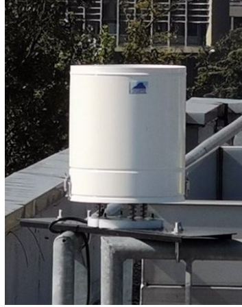
Figure 3-9. Picture of the Précis Mécanique 3029 rain gauge.
