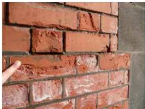
Altération d'un mur de brique dus à des cycles de cristallisation http://www.gub.ac.uk/geomaterials/lanvon.htm
