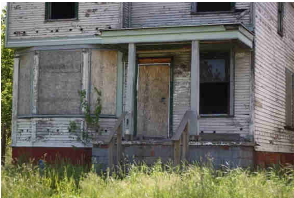
Les maisons abandonnées appartenant désormais aux pouvoirs publics (municipalité, comté etc.) ont les fenêtres et portes murées afin d'éviter qu'elles ne soient squattées ou visitées.
