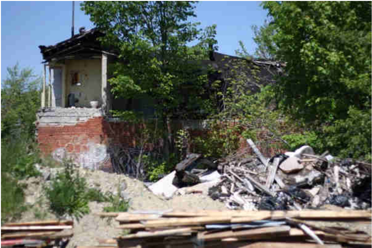
Une maison abandonnée et en ruine à Jefferson-Mack, désossée, envahie par la végétation et bordée d'une décharge sauvage.
