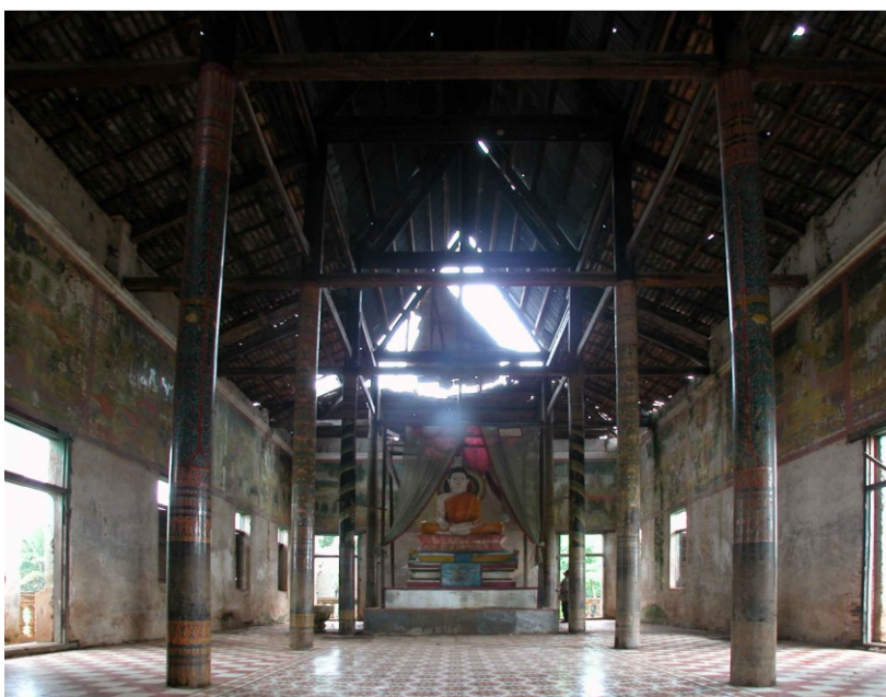
Intérieur du sanctuaire en état de quasi abandon, montrant le délabrement de la couverture et des baies. Septembre 2003
