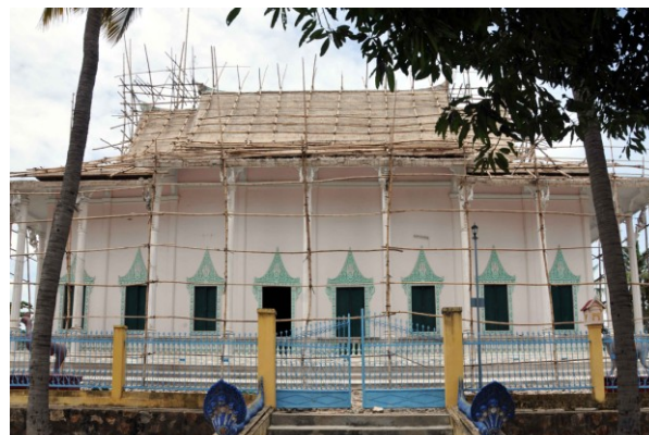
Vue du nord en juin 2011 montrant la réparation du toit à couverture en béton armé, avant la pose des nouvelles tuiles
