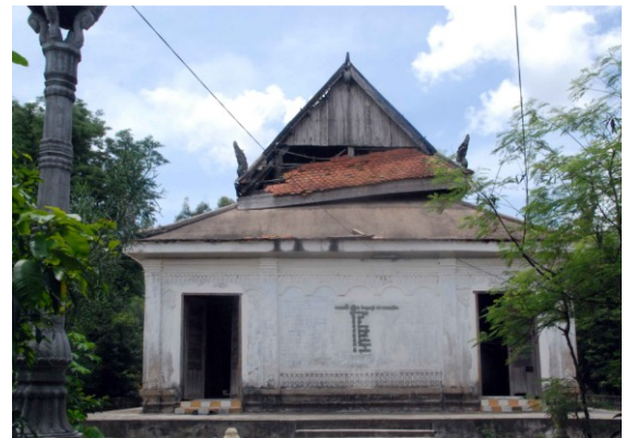
Sanctuaire. Vue du côté ouest montrant la dégradation du toit en 2011
