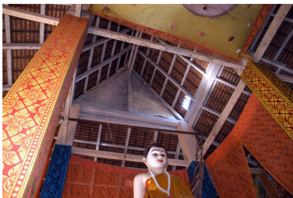
Vue intérieure du sanctuaire montrant l'ossature en béton armé de la charpente et l'arrière du fronton ouest
