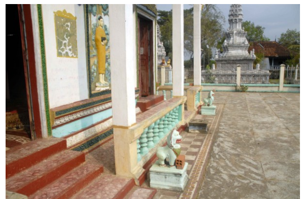
Obstruction de la galerie par les marches d'accès à l'intérieur du sanctuaire
