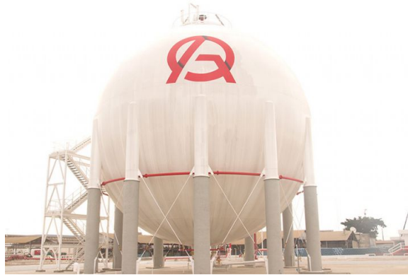
FIGURE 1.3 – Sphère de stockage de gaz butane à Abidjan.
