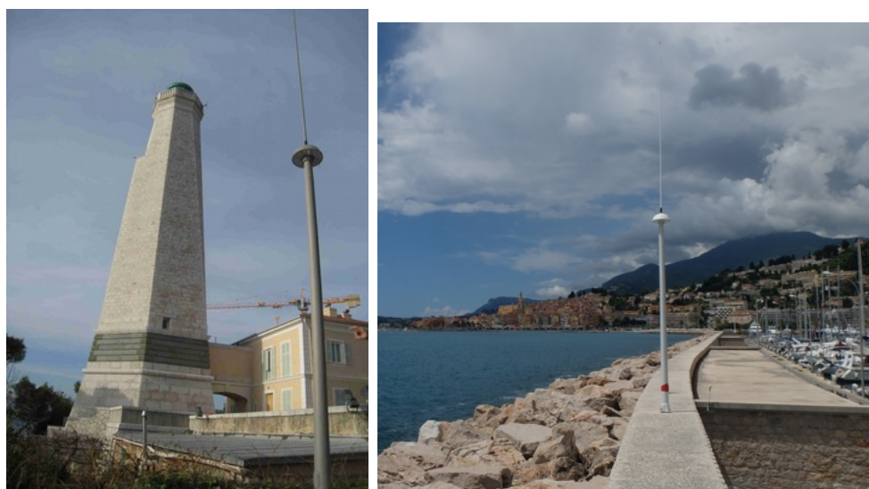
Figure 4.4: Installations des radars CODAR du MIO. À gauche : Radar du cap Ferrat. À droite : radar de Menton.
