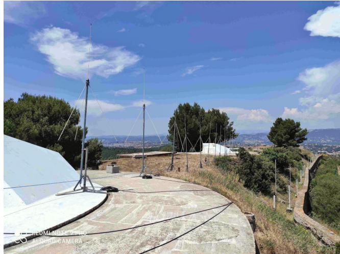
Figure 3.1: Installation VHF du Fort Peyras. Le réseau est installé sur les plateformes et est constitué de 16 antennes. En bas à droite de la photo, on aperçoit le réseau HF de Peyras le long du muret.
