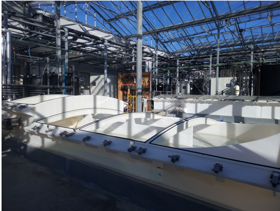
FIGURE 1.2 – Photographie d'un raceway ouvert installé sous la serre de la plateforme Algosolis.
