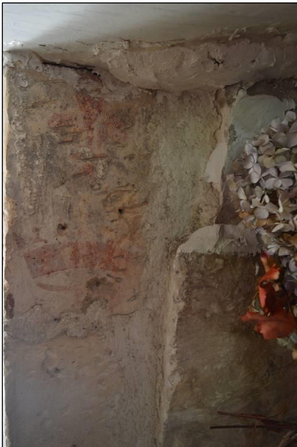
Figure 11.43 : Bâtiment D, mur méridional, intérieur, peinture d'une couronne et d'une fleur de lys (© Lise Levieux).
