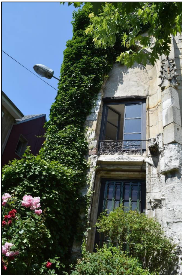
Figure 11.16 : Façade méridionale, partie ouest endommagée à cause du percement de rue (© Lise Levieux).
