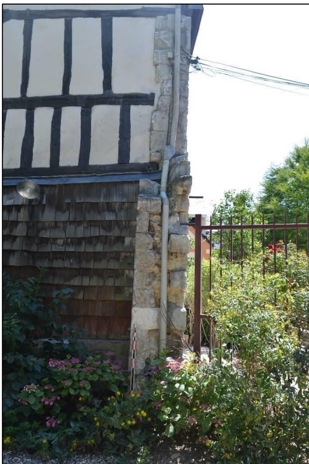
Figure 11.41 : Bâtiment D, façade septentrionale, arrachement (© Lise Levieux).
