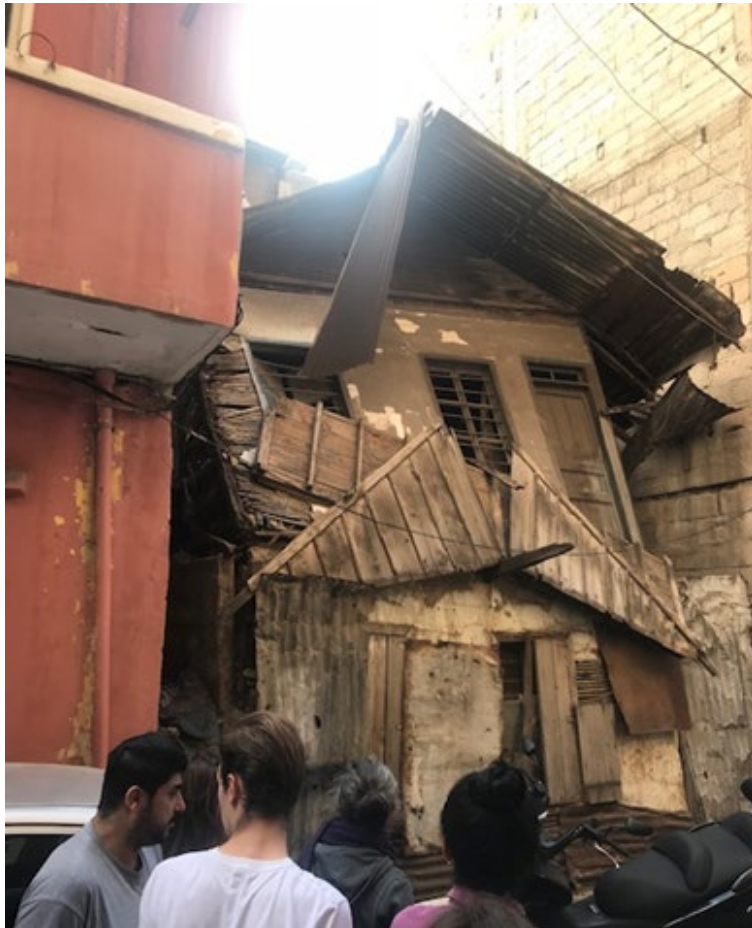
Figure 49: La maison arménienne en mauvais état repérée dans le quartier de la rue Marach. Source : photo pris par FAYAD, Nadine, le 1 décembre 2018
