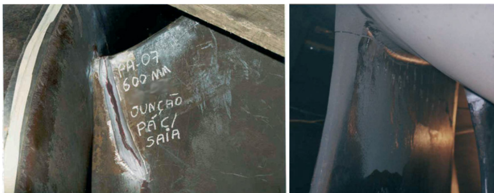
(a) Fissure à la jonction aube/ceinture
