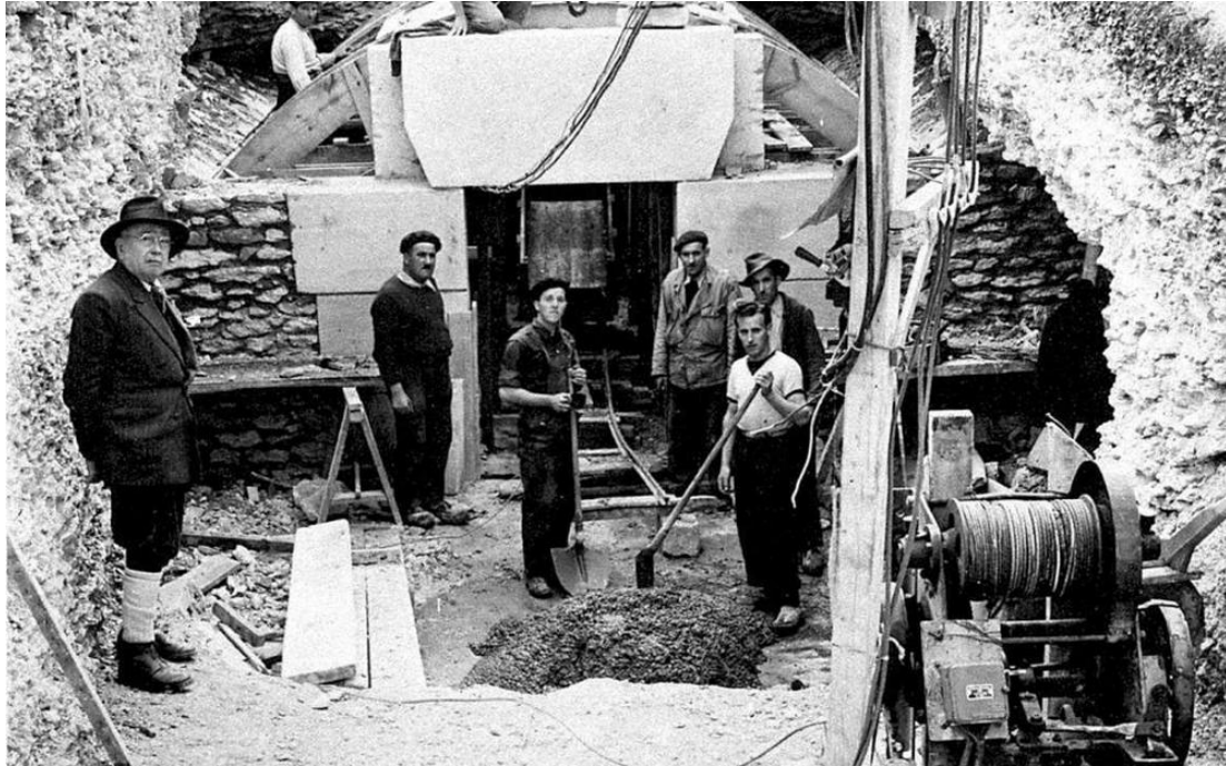
FIGURE 1.4 – Travaux d'aménagement des années 1947-1948 (Fernand Windels) - construction d'un Sas à l'entrée de la grotte.
