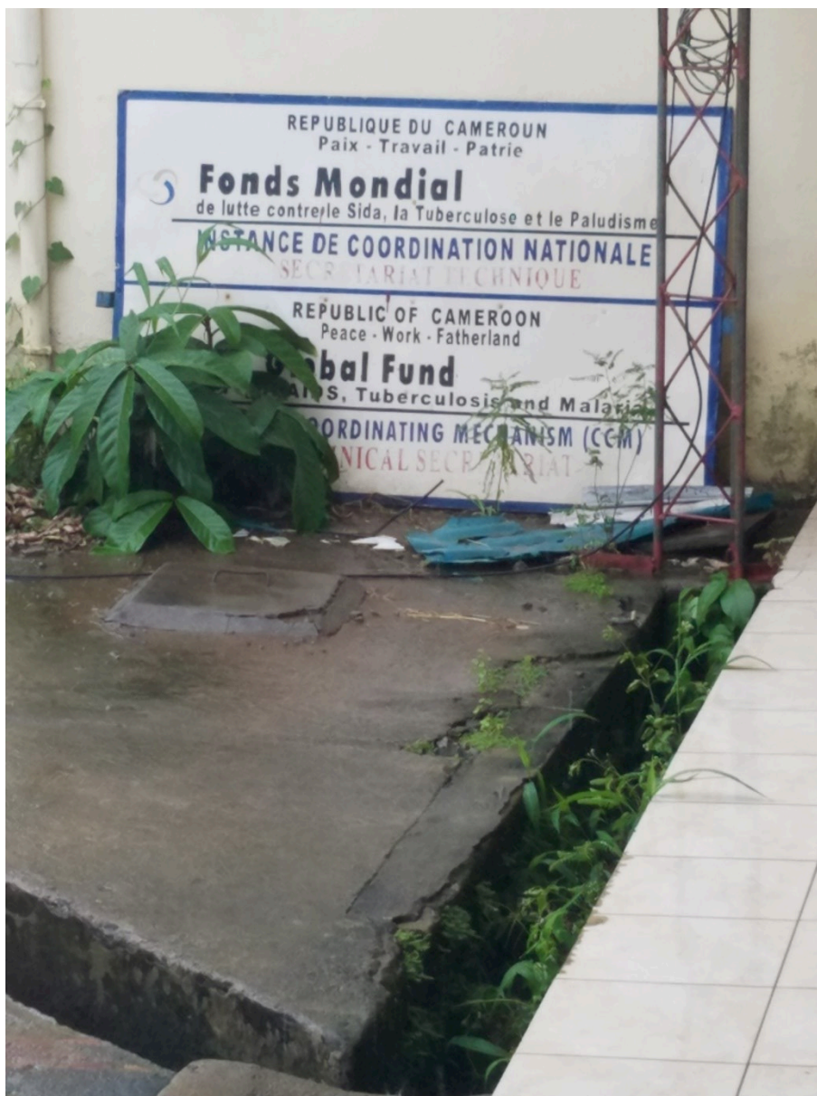
Photo 1 : Dégradation de l’enseigne du CCM
