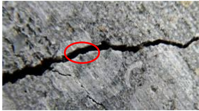
Figure 5.7 : La fissure traverse les granulats dans le BHP
