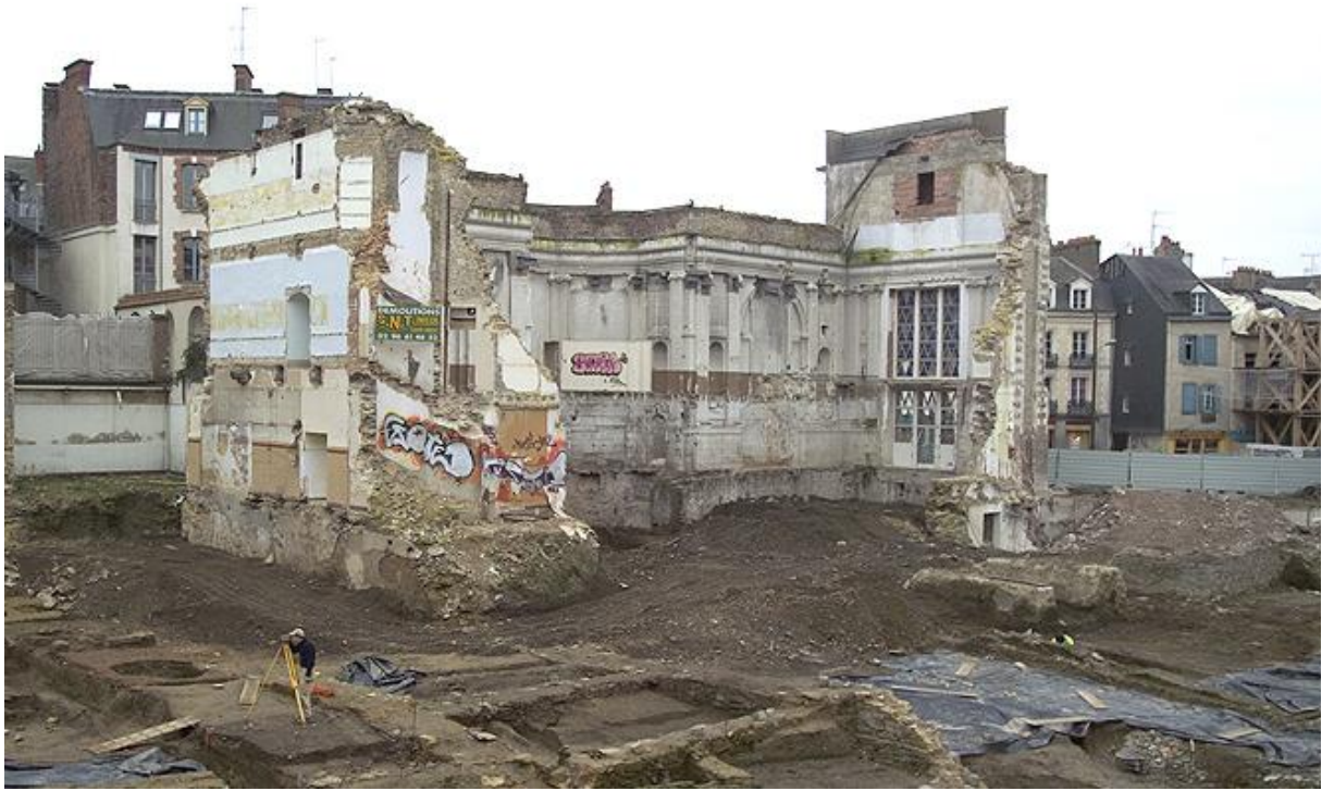
Figure 324 : Vue du chantier de démolition du collège de l'Immaculée, rue de la Visitation et la chapelle en ruine. Cl. Gérard Prudor, Musée de Bretagne, Rennes, 2004.
