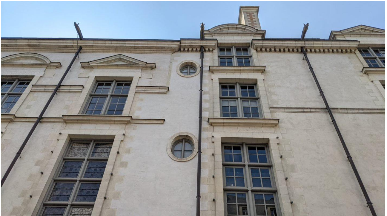
Figure 102 : Détail de la jointure entre l'aile nord et l'extrémité de l'aile ouest sur la face nord du Parlement de Bretagne édifiées par Jacques Corbineau (1624-1631), Cl. Jouan Jessy, 2020.
