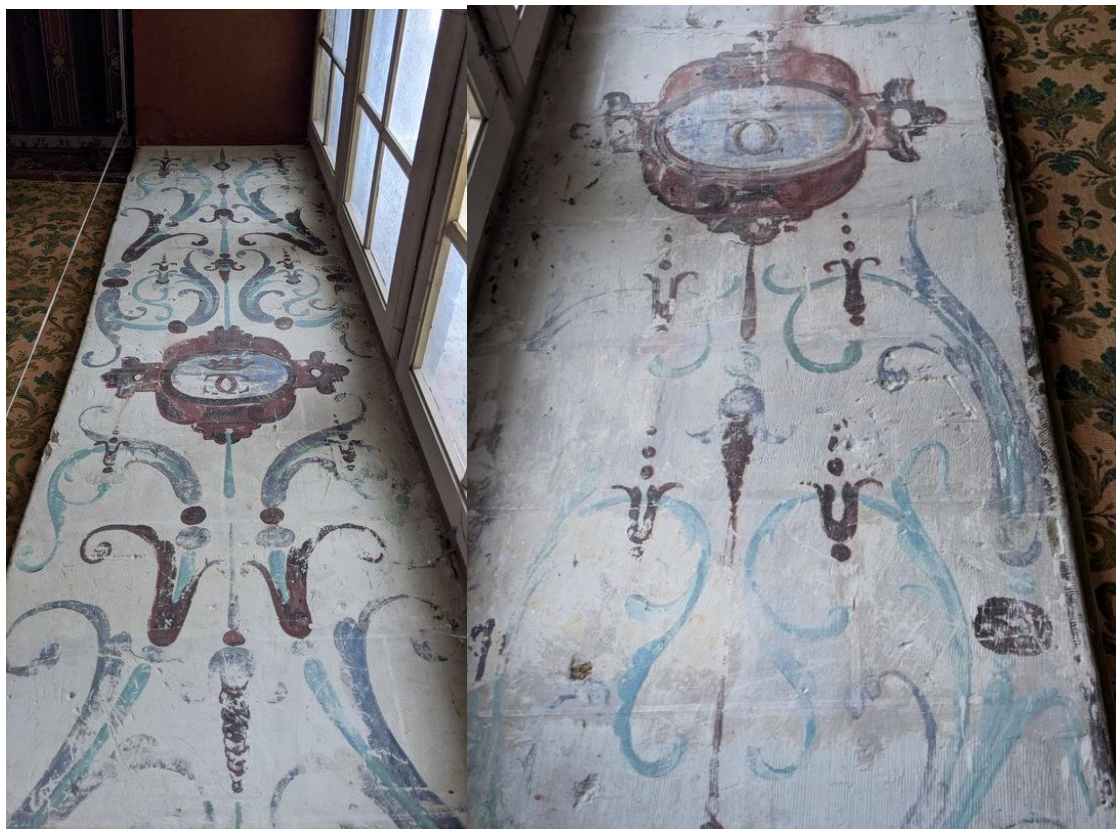
Figure 18 : Détail des décors peints à fresque aux encadrements intérieurs de fenêtres de l'appartement du niveau R+2 du pavillon nord du château de Brissac. Cl. Jouan Jessy, 2019.
