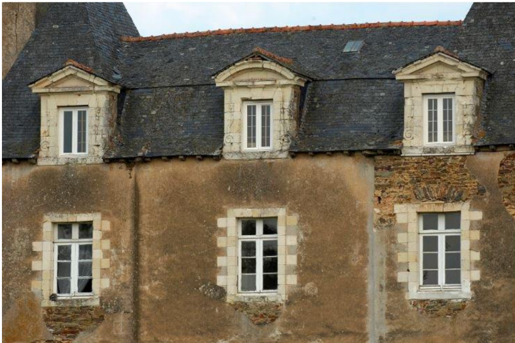
Figure 400 : Détail des fenêtres et lucarnes du manoir de la Louvière. Cl. Norbert Lambart, Inventaire du patrimoine Région Bretagne, 2008, IVR53_20083501364NUCA.
