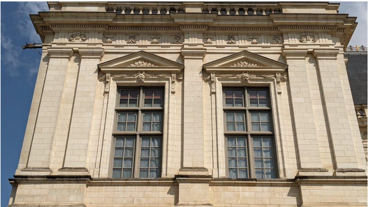
Figure 106 : Travées du pavillon gauche de la façade sud du Parlement de Bretagne édifée par Pierre Corbineau (1646-1655), Cliché, Jouan Jessy, 2020.
