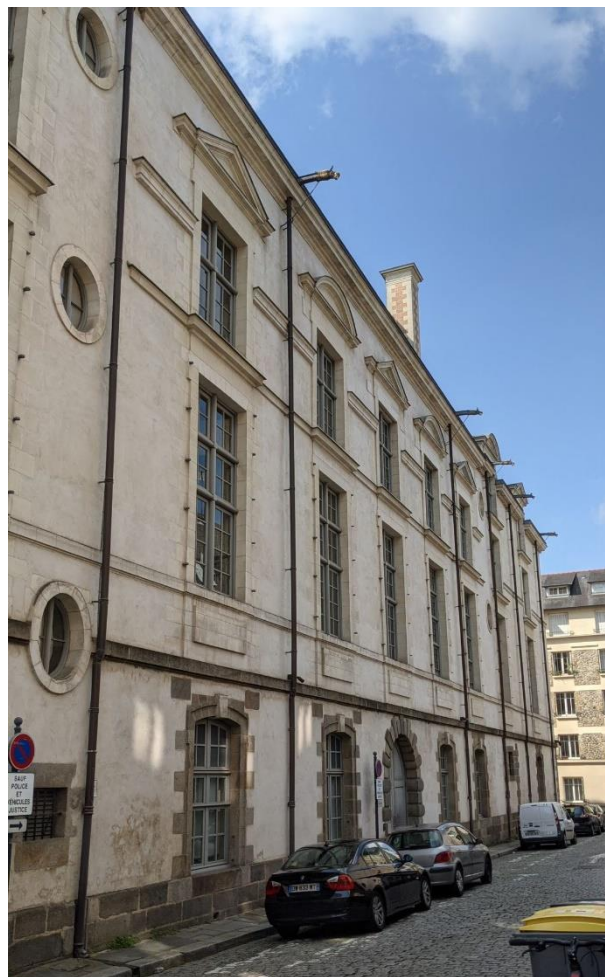
Figure 100 : Élévations de la face septentrionale de l'aile nord du palais du parlement de Bretagne. Partie édifiée par Jacques Corbineau entre 1626 et 1631. Cl. Jessy Jouan 2020.
