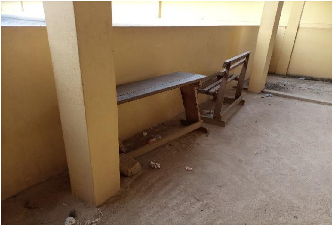
Figure 102 Des tables bancs endommagés suite aux déplacements, crédit : Oussou, février 2022
