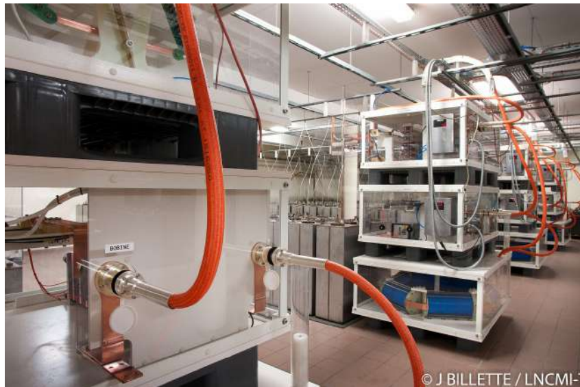
FIGURE 2.13 – Installation 14 MJ du LNCMI Toulouse. Les condensateurs sont les parallélépipèdes métalliques en arrière plan de la photographie.
