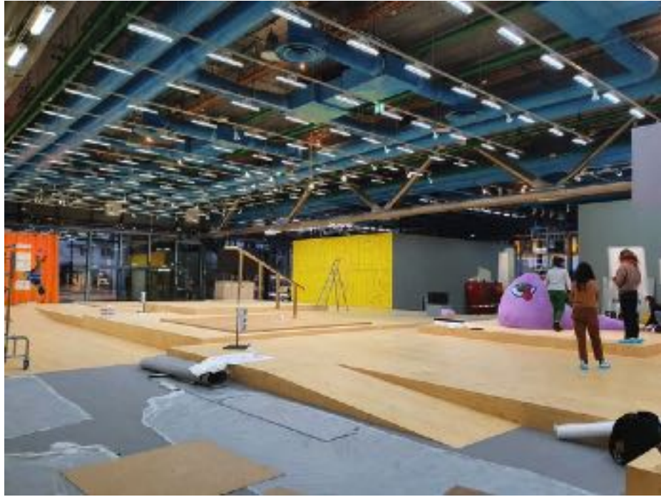
Parcours d'estrades et de socles sur différents niveaux, vue en cours de montage Exposition d'Hassan Khan, Blind Ambition , au Centre Georges Pompidou (Galerie 3, niveau 1), à Paris du 23 février au 25 avril 2022
