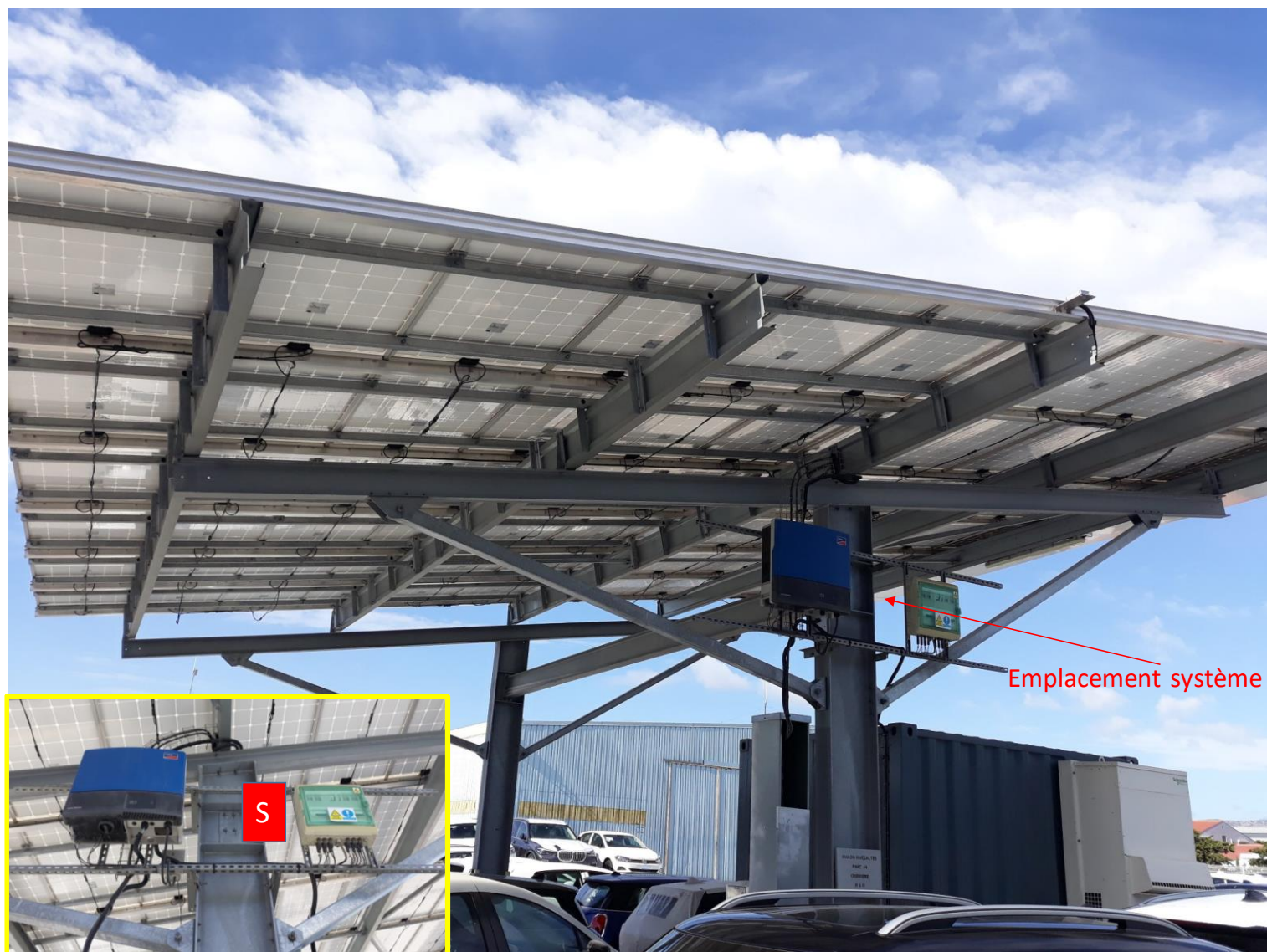
Figure 5.5: Photo de l'ombrière et l'endroit de l'installation du système
