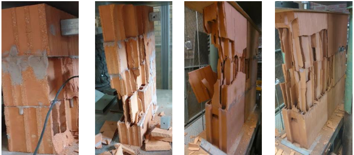
Figure 3.26 – Les formes de rupture des murets durant un essai de compression.
