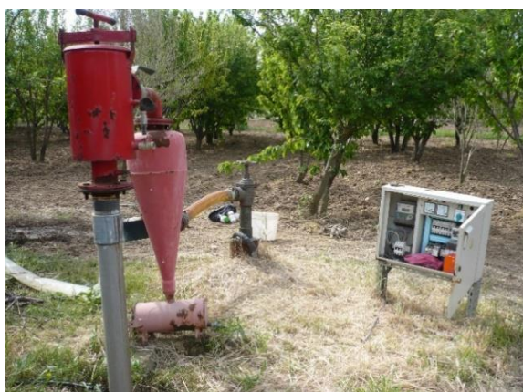
Forage individuel, système de filtration (hydrocyclone et filtre à disques) et raccord électrique (Ören, 2015)
