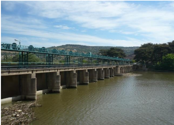
Régulateur d'Emiralem dérivant l'eau du Gediz dans deux canaux primaires (Emiralem, 2015)
