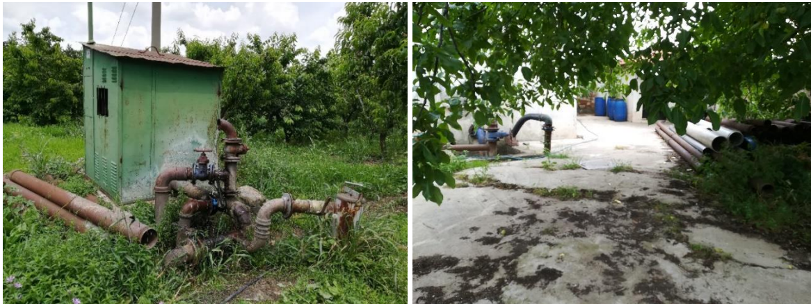
Figure 64. Photos du matériel stocké par la coopérative près de forages (2018)
