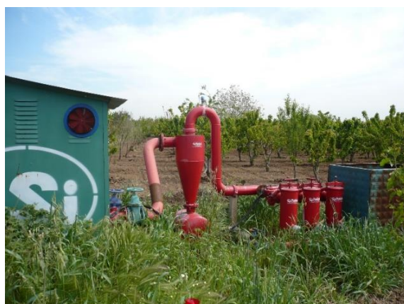
Forage collectif (et système de filtration) réalisé par le DSI pour une coopérative d'irrigation (Armutlu, 2015)
