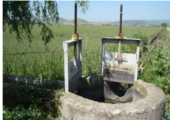
Système de distribution de l'eau dans le périmètre des associations d'irrigants (Türkelli, 2015)
