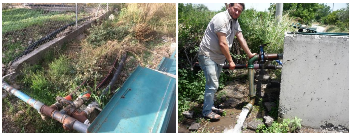
Figure 67. Ensembles de vannes individuelles sur les hydrants du projet de gölet (2017)
