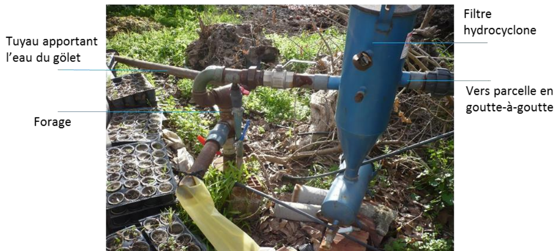
Figure 69. Arrivée de l’eau du gölet sur le système de forage à Emiralem (2016)
