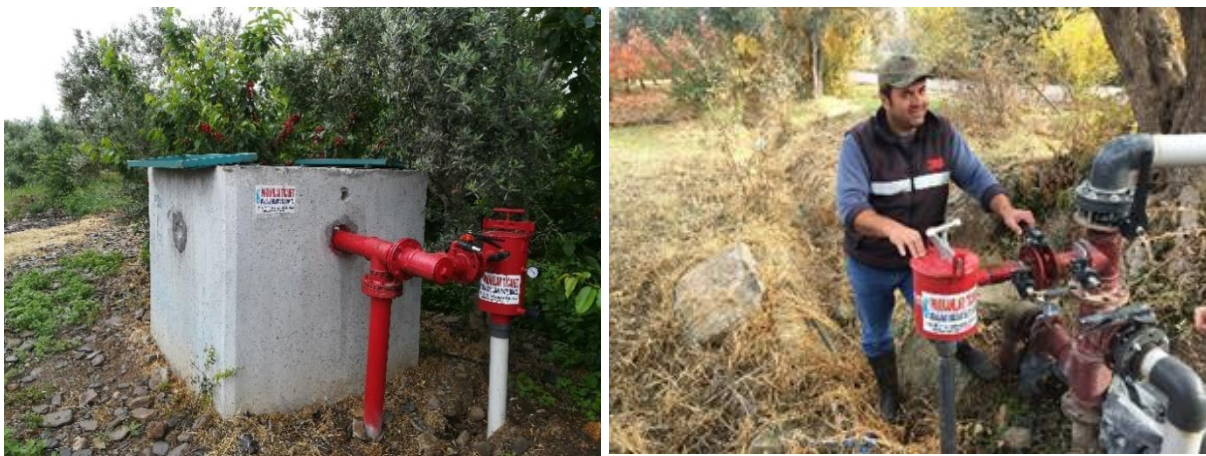
Figure 65. Photos des vannes du gölet raccordées au réseau de distribution des eaux souterraines (2017)
