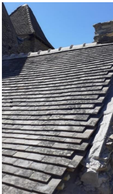
Figure 156- Détail de la finalisation des travaux de restauration du château de Pontus de Tyard. Source : Minardi, 2022.
