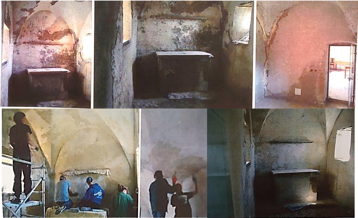
Figure 136 – Chapelle pendant l'intervention. Source : Rapport 2016 fourni par REMPART et compilé par l'auteur (2023).
