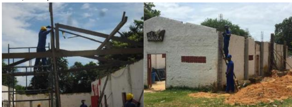
Figure 60 - Démontage des vieilles poutres détériorées du toit de l'abri et assemblage des nouveaux piliers.
