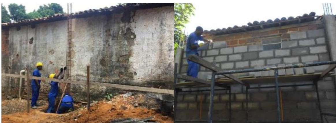
Figure 61 - Réalisation des ferrures pour les nouveaux piliers du sacré et élévation du mur du sacré. Source : 3ème RAPPORT PHOTOGRAPHIQUE - PÉRIODE 21/11/2018 AU 31/12/2018 1192 .
