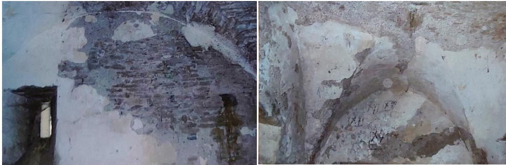
Figure 135 – Chapelle avant l'intervention. Source : Rapport 2015 fourni par REMPART.
