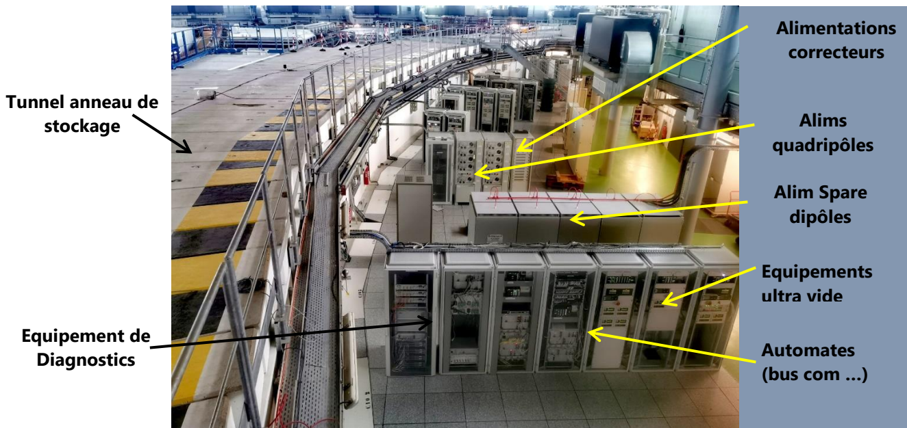
Figure 1-20: Hall opérationnel des alimentations des électro-aimants et d'autres équipements scientifiques [source SOLEIL]
