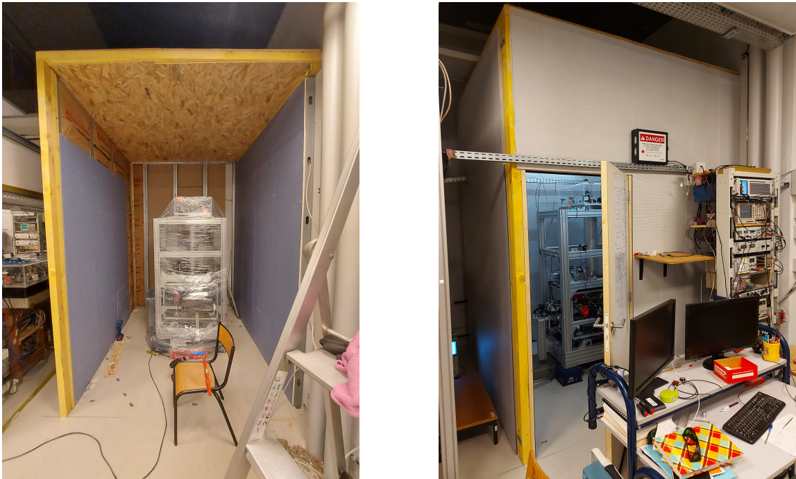
FIGURE 2.2 – Photographies de la nouvelle boîte de protection de l'expérience (pendant la construction et actuellement)
