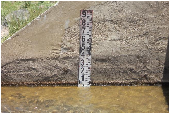
Photo 4-1 Echelles limnimétriques installée dans l'amont de l'Oued Amengous (El Orfi, 2019)
