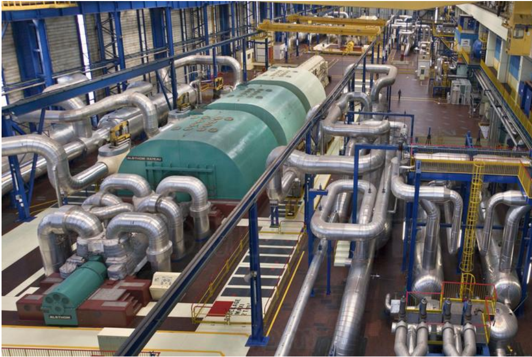
Figure F-2. Photographie d'un groupe turbo-alternateur de 900 MW au Bugey, par [129]
