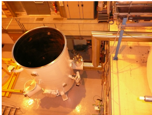
FIGURE 2.5. Vue du CMT et de la ligne de transfert.
