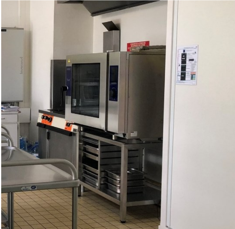
Figure 61 : Équipements de cuisson de la cuisine de l'école La Garenne , Perche (2022)
