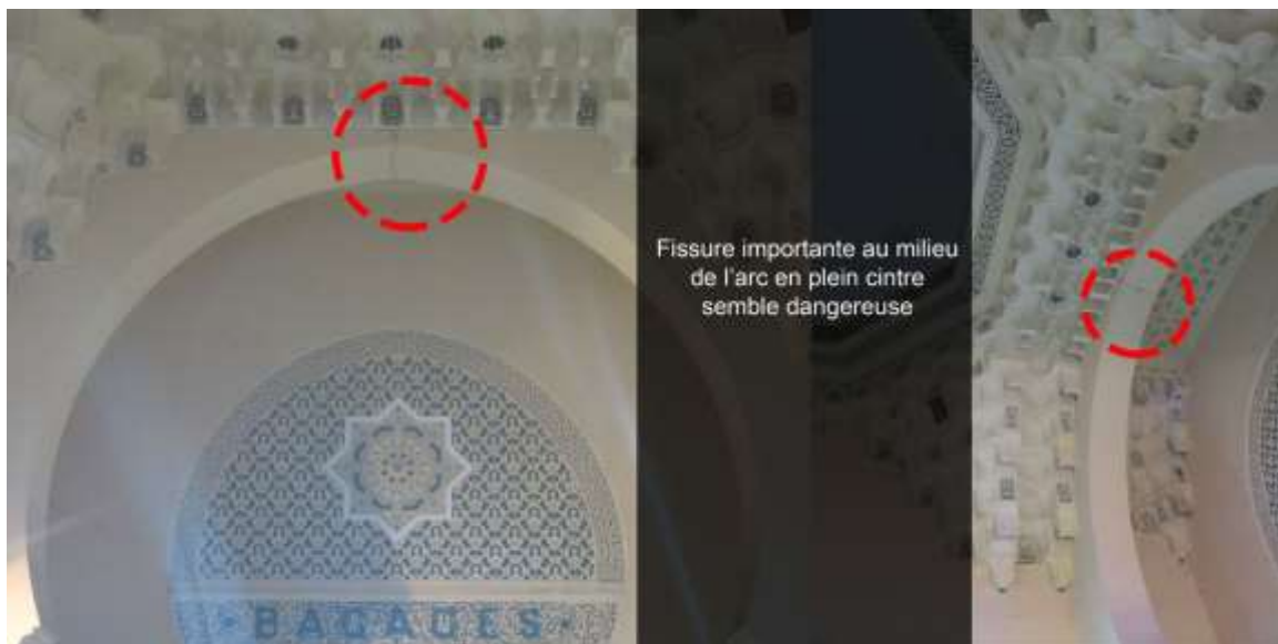
Figure 303 : État de l'arc en plein cintre de la gare d'Oran, 2019 603
