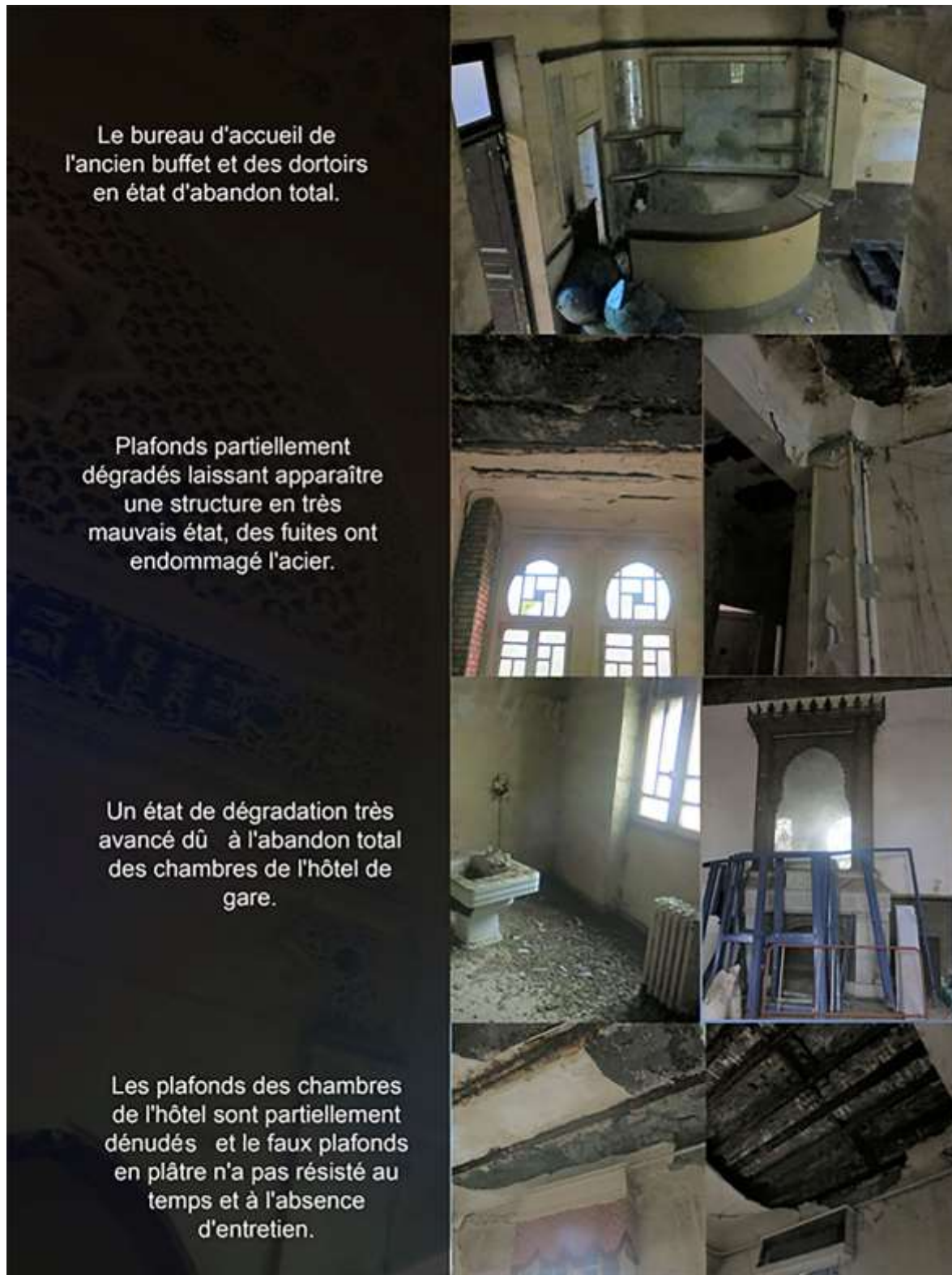
Figure 52 : État de l'intérieur du bâtiment du buffet et du dortoir de la gare d'Oran, 2019 57
