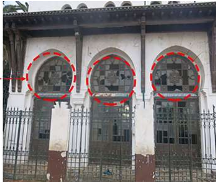
Figure 299 : État des vitres sur une des façades du buffet de la gare d'Oran, 2019
