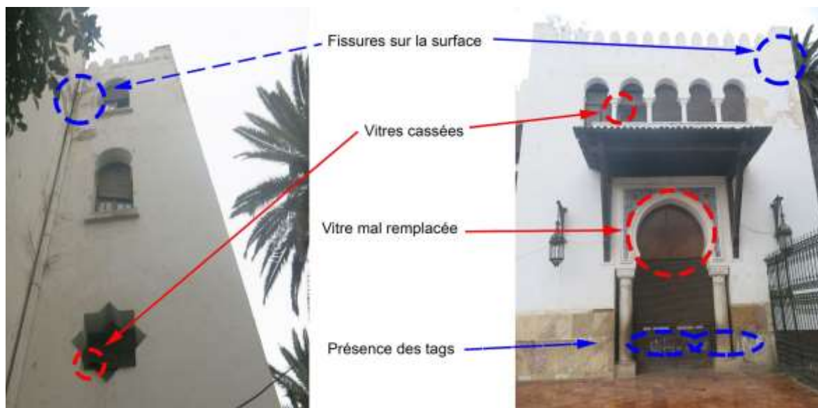
Figure 300 : État de quelques éléments d'architecture de la gare d'Oran, 2019 599
