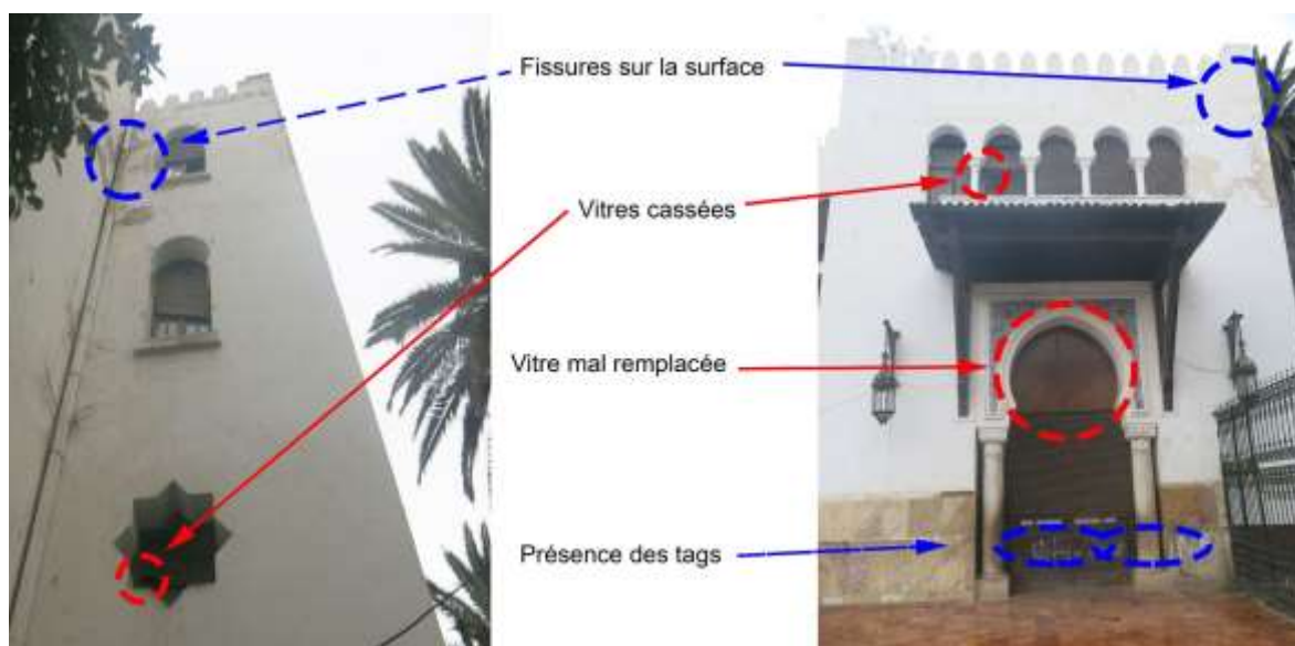
Figure 49 : État de quelques éléments d'architecture de la gare d'Oran, 2019 53
