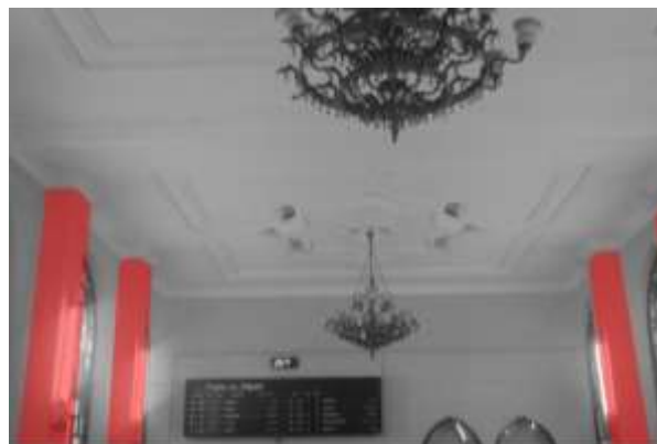
Figure 280 : En rouge, les poteaux maintenant la toiture dans la salle d'attente de la gare d'Oran 571
