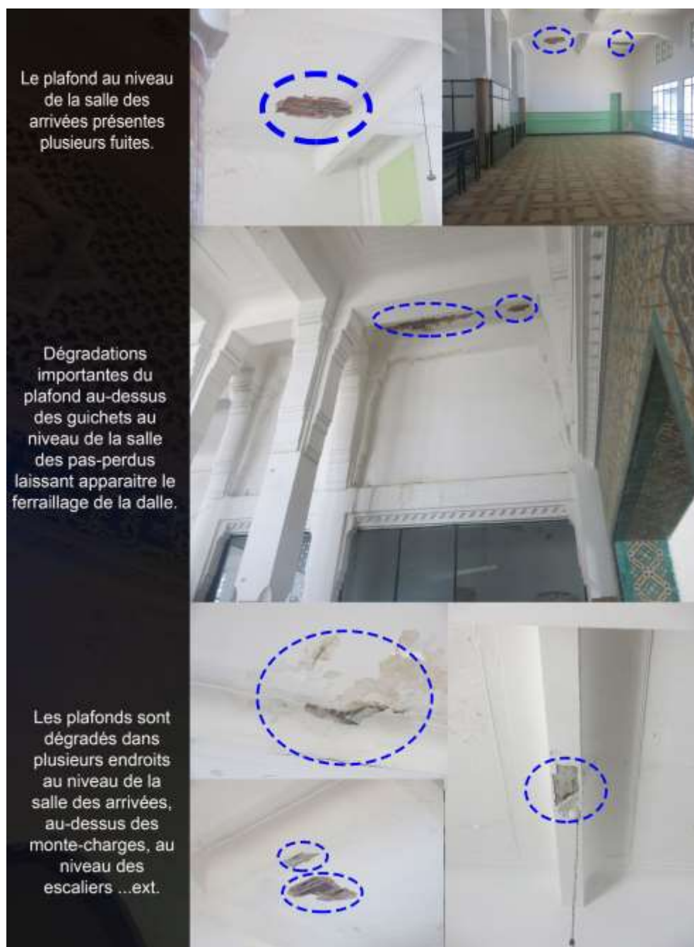
Figure 310 : L'état du plafond de la gare de Skikda, 2019 609
