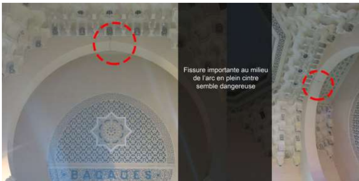
Figure 51 : État de l'arc en plein cintre de la gare d'Oran, 2019 56
