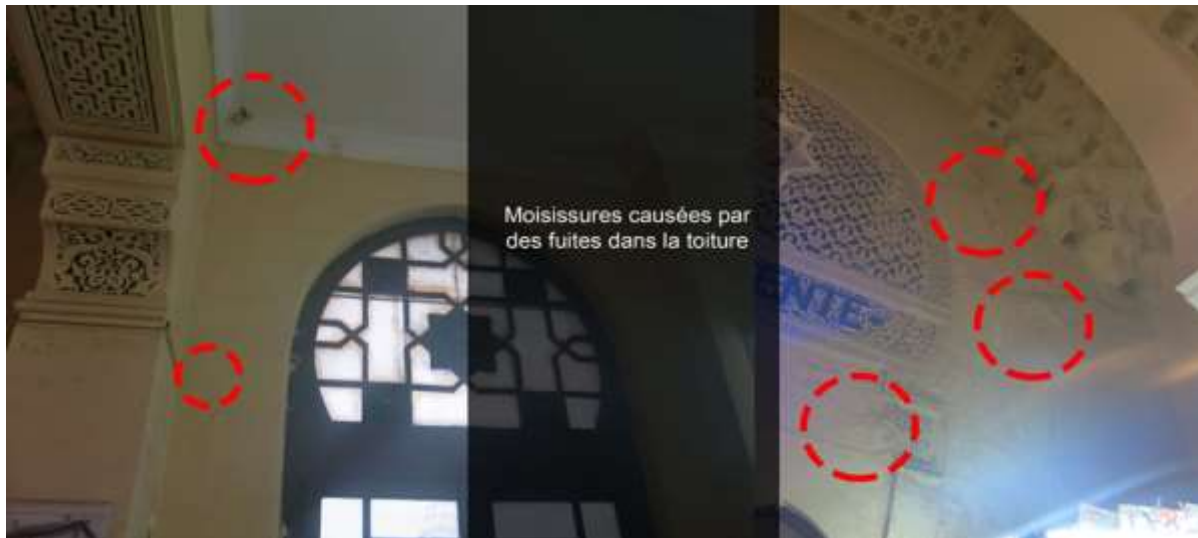
Figure 50 : État de quelques cloisons au niveau de la salle des pas perdus et de la salle d'attente de la gare d'Oran, 2019 55
