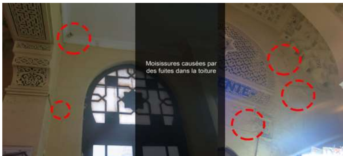
Figure 301 : État de quelques cloisons au niveau de la salle des pas perdus et de la salle d'attente de la gare d'Oran, 2019 601
