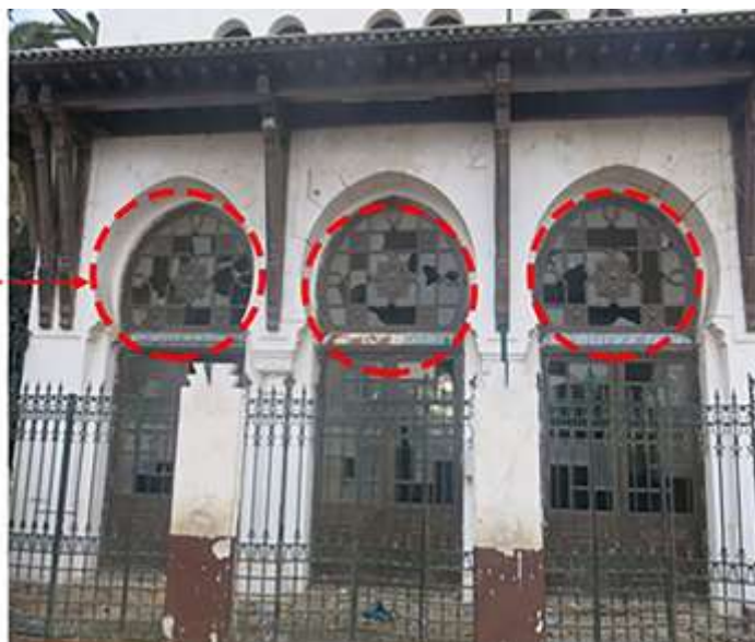
Figure 48 : État des vitres sur une des façades du buffet de la gare d'Oran, 2019
