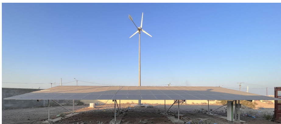
FIGURE 3.3 : Éolienne ANTARIS installée sur le site de la centrale de l'université.
