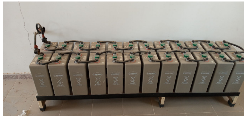
FIGURE 5.9 : Photo des anciennes batteries initialement installées à la centrale.
