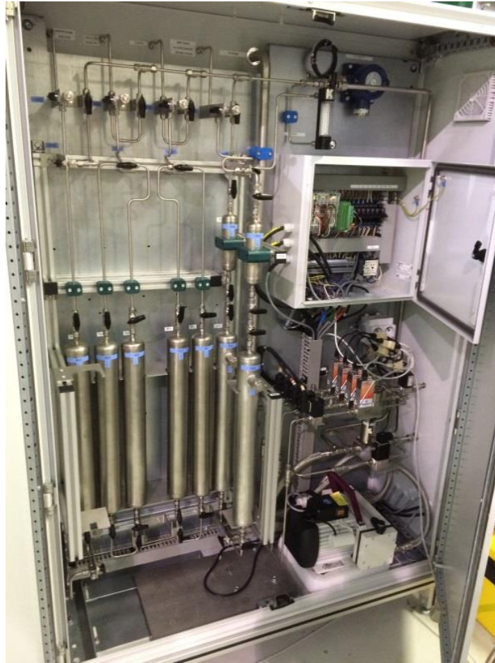
Figure 47. Système de régulation du mélange gazeux, modifié avec l'ajout de filtres supplémentaires et de nouvelles connectiques. Ces modifications permettront de limiter l'apparition d'impuretés dans le mélange gazeux.
