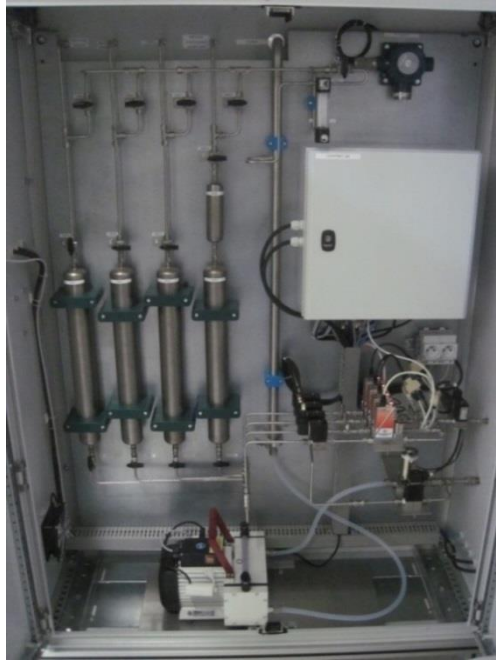
Figure 40. Système régulateur et mélangeur de gaz réceptionné en 2012. Ce système comporte plusieurs voies d'entrée avec des filtres pour purifier les gaz et des débitmètres pour gérer la composition du mélange gazeux. La voie de sortie est composée d'une vanne permettant de réguler la pression et d'une pompe pour éjecter le gaz vers l'extérieur. Chaque élément est détaillé dans les Figure 41 et Figure 42.
