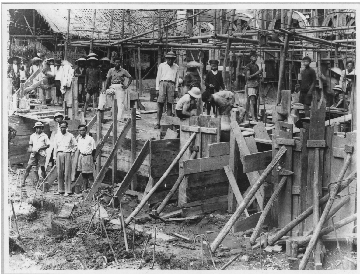
Figure 32: EFEO : chantier de construction pour la nouvelle bibliothèque, travaux et artisans (vue d'ensemble) (légende de la photothèque de l'EFEO) – Photothèque de l'EFEO VIE23179 bis
