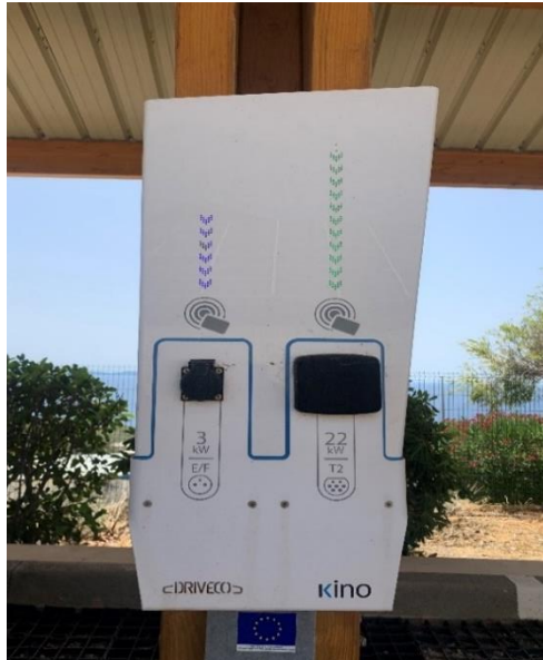
Figure 2-7 : Borne de recharge de véhicule électrique de PAGLIA ORBA
