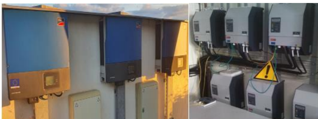
Figure 2-9 : Onduleur PV réseau et onduleur chargeur
