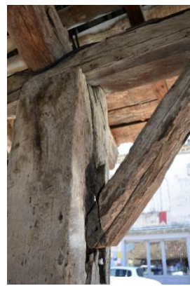
d) Rupture de l'assemblage d'une jambe de force, carré extérieur, coin nord-ouest
