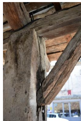
d) Rupture de l'assemblage d'une jambe de force, carré extérieur, coin nord-ouest
