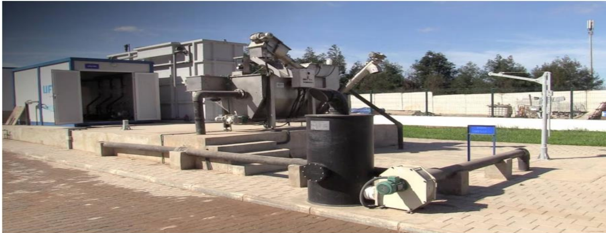
Figure 114. Station d'épuration des eaux usées au campus de l'UIT
