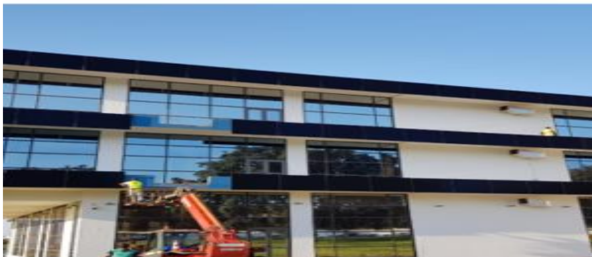
Figure 88. Façade solaire installée sur les bâtiments du campus de l'UIT
