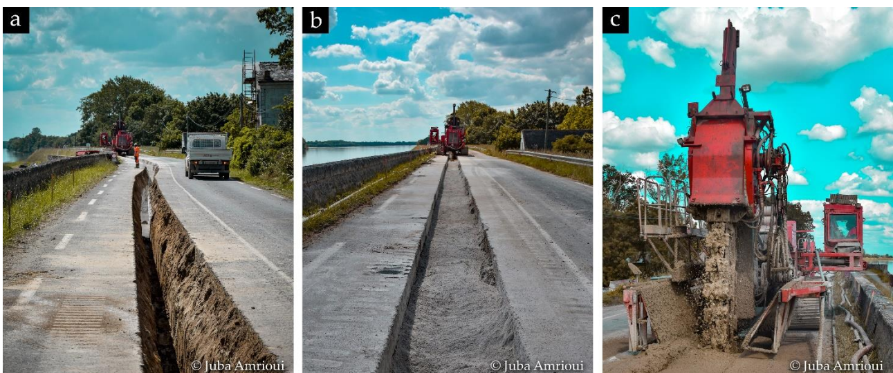
Fig. 8. (a) Réalisation de la prétranchée ; (b) Epandage du ciment ; (c) Malaxage et injection d'eau (© J. Amrioui – site LA)
