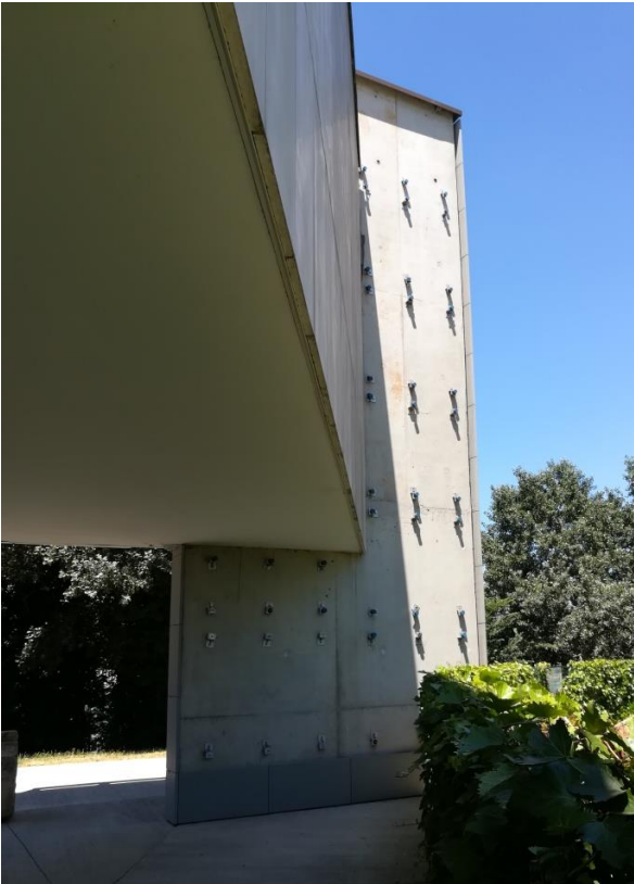
Façade, plaques cassés d'émailit, photographie, 1983-1995. Cliché Alice Agostini, juin 2016.
