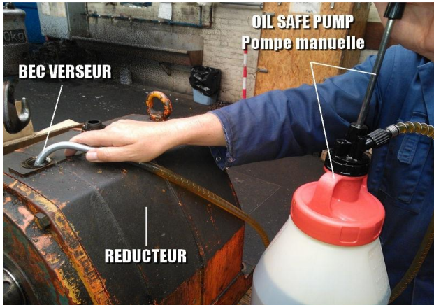
Figure 22 : Remplissage d'un réducteur à l'aide d'un oil-safe
