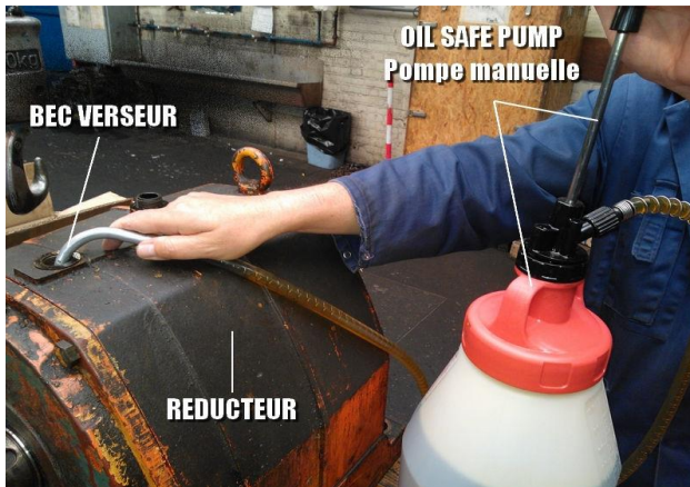
Figure 22 : Remplissage d'un réducteur à l'aide d'un oil-safe
