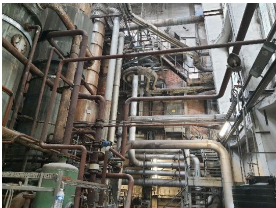
Figure 11 : Salle des pompes des produits chimiques
