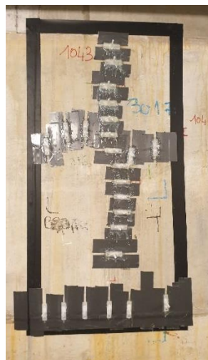
Figure VII.13 : Fissure GOU 3017 préparée pour l'injection.
