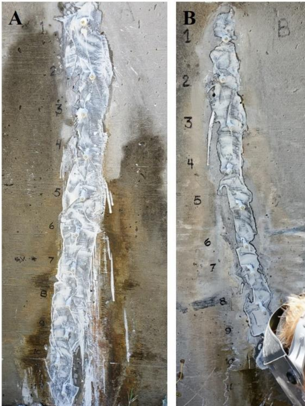
A : fissure A. B : fissure B.
