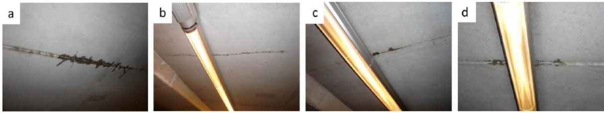
a et b : fissures témoins non traitées, c et d : fissures traitées.
