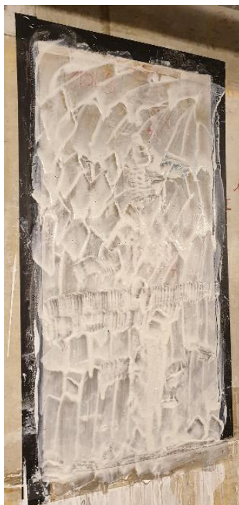
Figure VII.14 : Fissure GOU 3017 badigeonnée avec Gmin.
