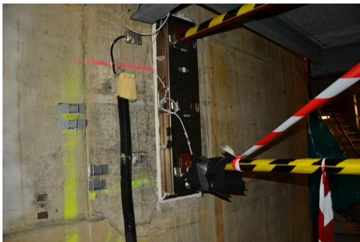
Figure VII.20 : Boîte collectrice permettant de mesurer le débit de fuite de la fissure verticale GOU 2005.
