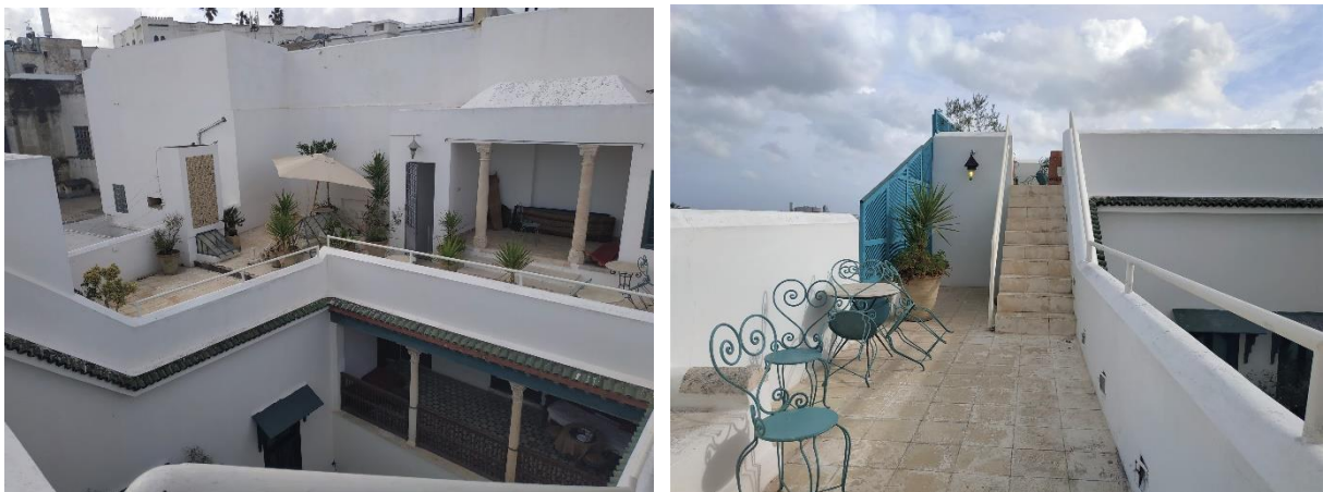
Figure 149 : Vues sur la toiture-terrasse, photos prises par Iman Batita le 19/07/2018 à Tunis
