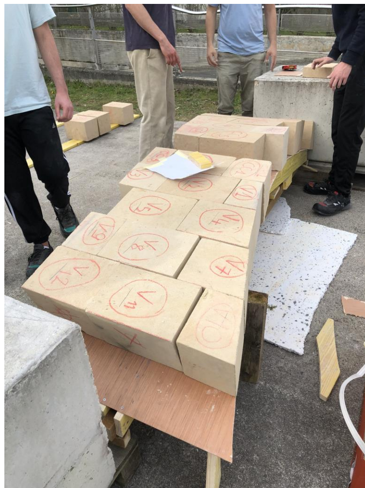
Figure j – Pose des blocs taillés de la passerelle sur le cintre
