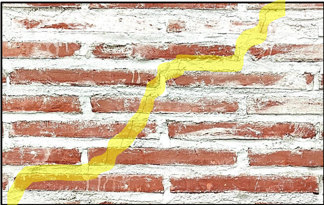
Figure 4.26 : Mode de rupture du mur MNR expérimental (le tracé jaune indique la position de la fissure)
