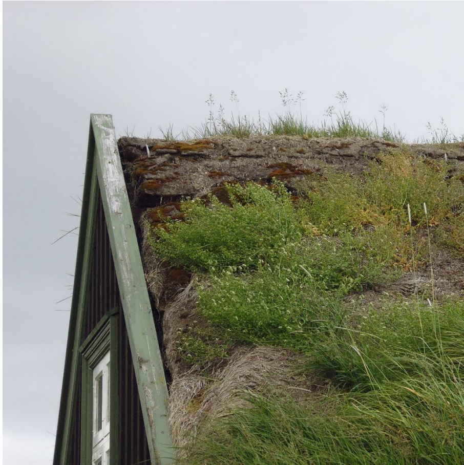
Figure 199: vieillissement du faîtage de la maison de Litlibær. Cliché : SC, 2013.
