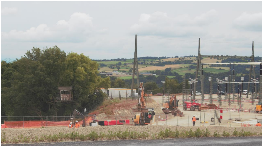
Figure 87 Une partie du poste électrique Sud-Aveyron en chantier. Au premier plan, les ouvriers et leurs machines s'affairent, au second plan la campagne aveyronnaise, dans les arbres une cabane de l'occupation des lieux par les militants de l'Amassada est le dernier vestige de cette contestation ©Jimmy Grimault, 2021
