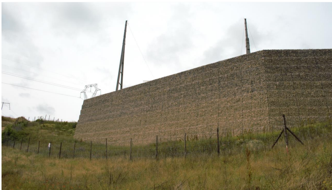
Figure 88 La plus grande distance voulue entre le hameau de Ayres et le poste électrique Sud-Aveyron a conduit à situer le poste dans un contrebas, ce qui a nécessité le renforcement de cette partie par un mur imposant donnant sur un espace non habité mais où les chasseurs passent régulièrement en suivant le gibier, ©Jimmy Grimault, 2021
